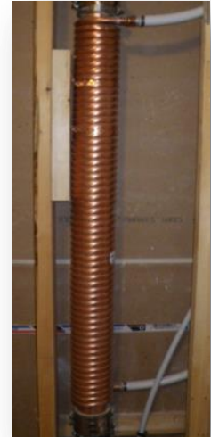
Figure 4 : Dispositif de récupération de la chaleur des eaux ménagères
