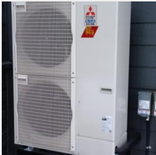
Figure 3 : Pompe à chaleur
